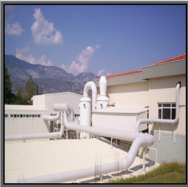
Koku Giderme Ünitesinden Görünüm
