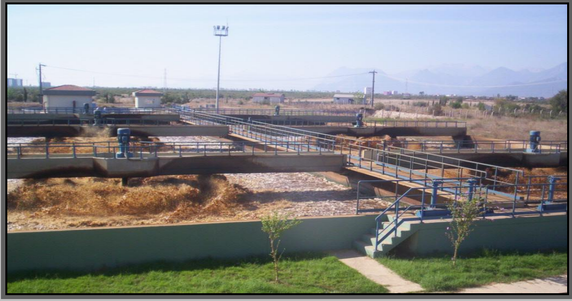
Havalandırma Havuzundan Görünüm
